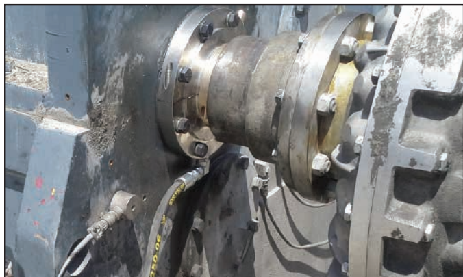
Es wurde ein externer Abfluss konstruiert, um der Überflutung im Lagergehäuse des SAG-Mühlengeriebes Rechnung zu tragen.
