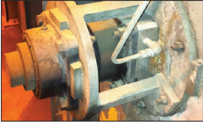
Eine Air Mizer-Dichtung verhindert das Austreten von Aschenschlamm aus einem Aschenförderer eines kohlegefeuerten Dampfkessels.
